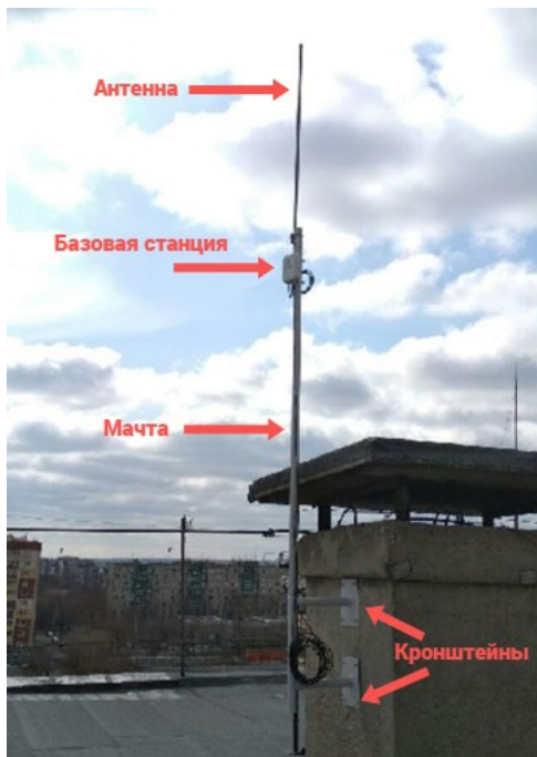
Рисунок 22 – Пример установки базовой станции и антенны
